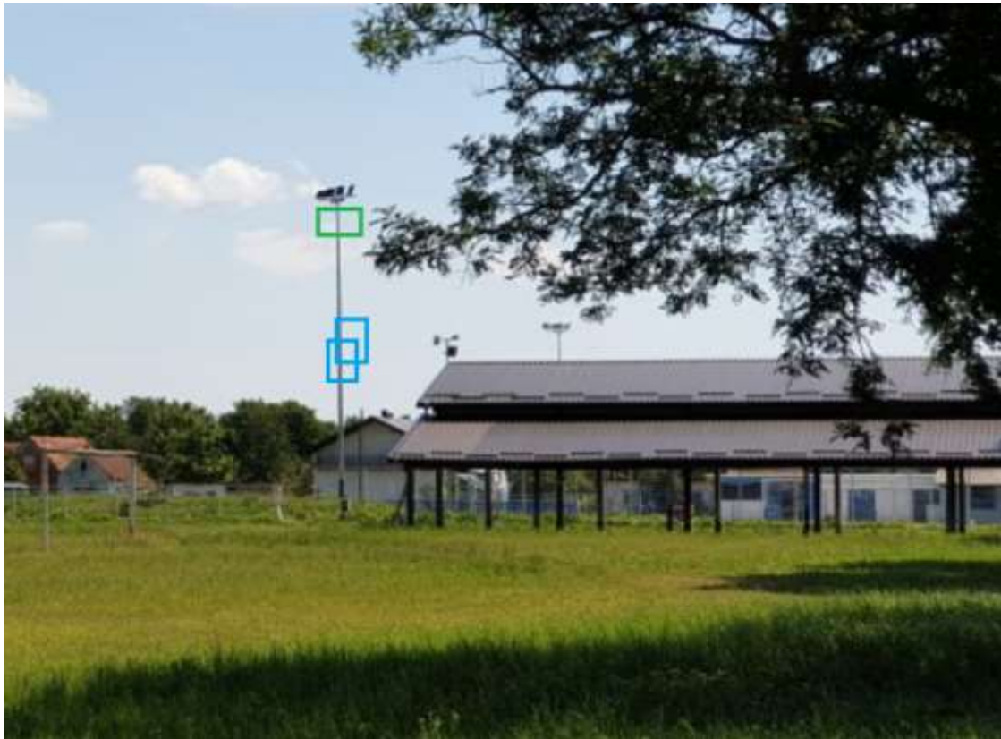
Slika 18: Smještaj opreme na reflektoru
